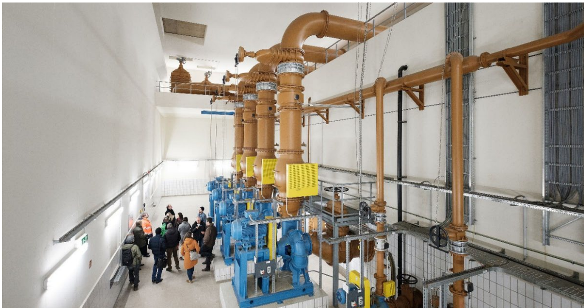
In einer Pumpstation in Köln: Einblicke in die Stadtentwässerungsstrategie im Kölner Stadtzentrum.
