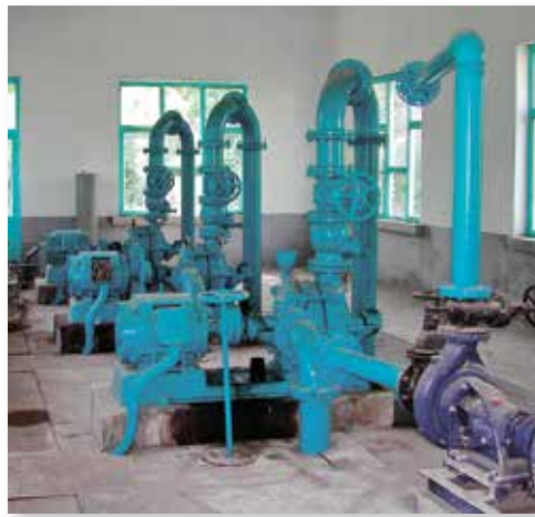
Eine Pumpstation mit deutscher Technologie aus den 1970er-Jahren ist zum Teil noch erhalten
