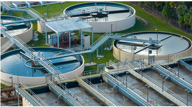
Moderne Wasseraufbereitungsanlage. Foto: Bilanol, Shutterstock
